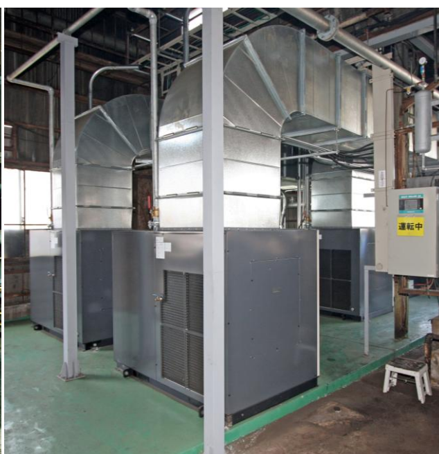
コンプレッサー
