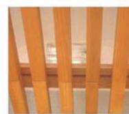
エントランス（風見堂）コンパクト型蛍光灯
