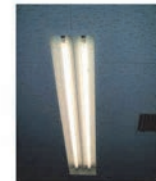
事務室 40W型蛍光灯
