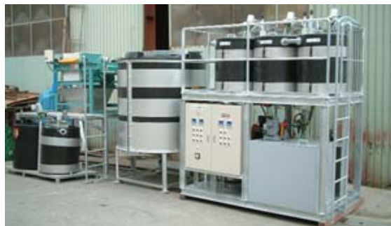
塗装前処理ユニット式排水処理設備(処理能力:1m 3 /hr)
