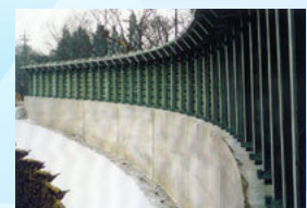
風雪吹き込み防止板
