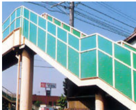
歩道橋目隠し板
