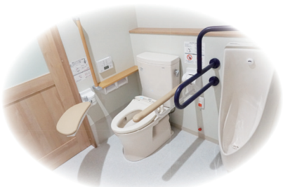
手すり付きで安心の広々トイレ
