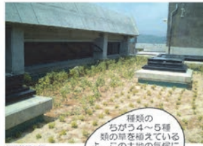
給気機屋上緑化
