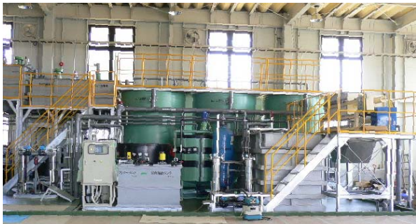
メッキ排水処理プラント(処理能力: 10m 3 /hr)
